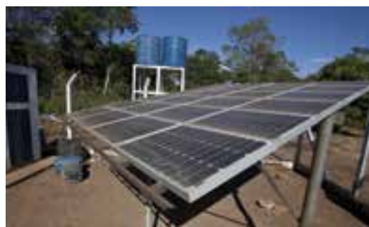
Painéis de energia solar.
